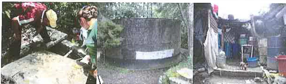
ILUSTRACIÓN 18: CAJAS DE CAPTACIÓN Y SISTEMAS DE ALMACENAMIENTO DEL AGUA LLUVIA EN RI.
