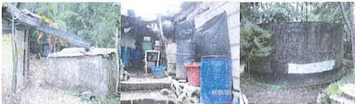
ILUSTRACIÓN 49: SISTEMA DE ALMACENAMIENTO DE AGUA LLUVIA EN EL CANTÓN EL PROGRESO.
