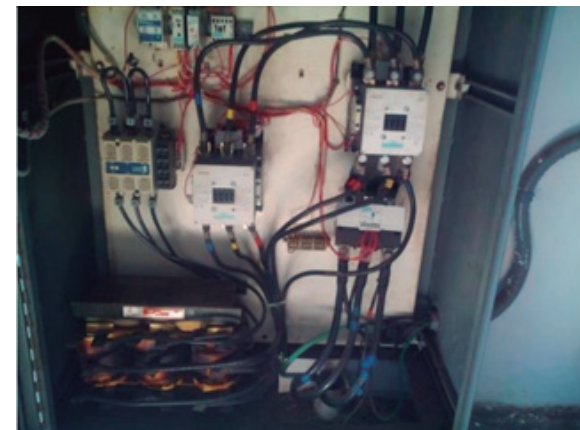
Arrancador de equipo de bombeo
