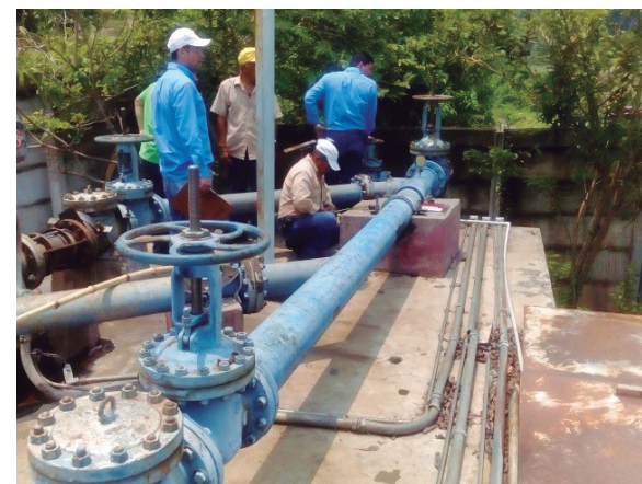
Cisterna de planta de bombeo Changuiste
