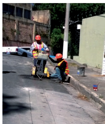
Sustitución de tuberías de agua potable y aguas negras en colonia Las Delicias, Santa Tecla, La Libertad
